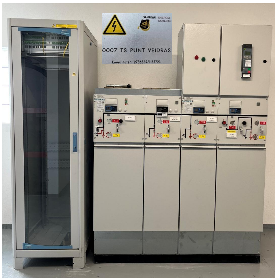
TS Punt Veidras Gesamtsanierung 2025 Mittelspannungsanlage und Kommunikationsschrank
