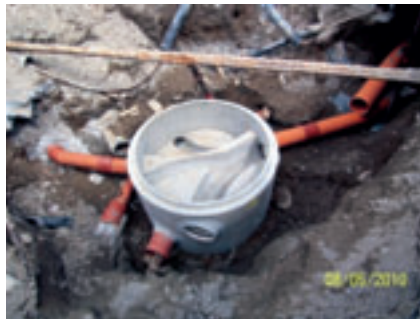
Kontrollschacht für Schmutz- und Meteorwasser
