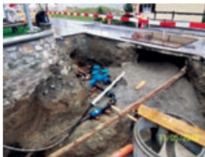
Absperrarmaturen bei der Wasserversorgung
