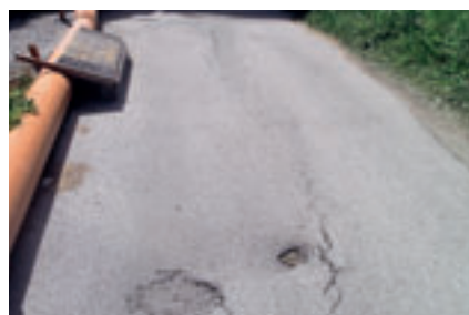
Eine Einbruchstelle ist auf dem Bild vorne im Belag zu sehen.
