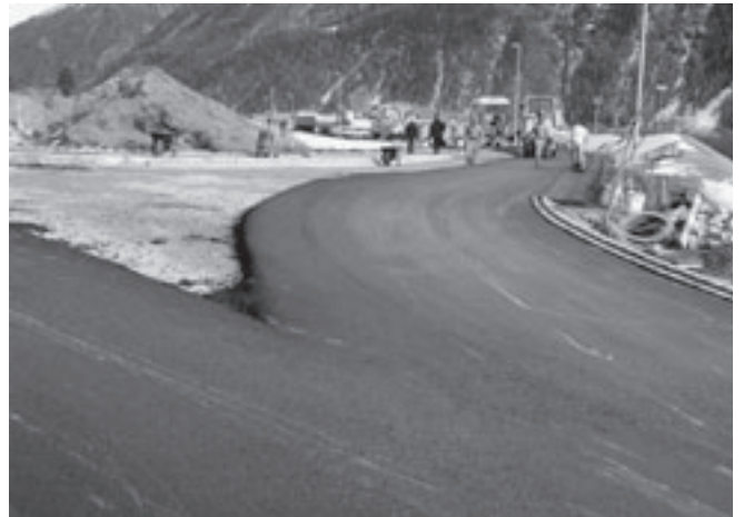
Belagszusammenschluss der Tragschicht HMT 22 bei der Einmündung kleine Umfahrung in die Via San Bastiaun.
