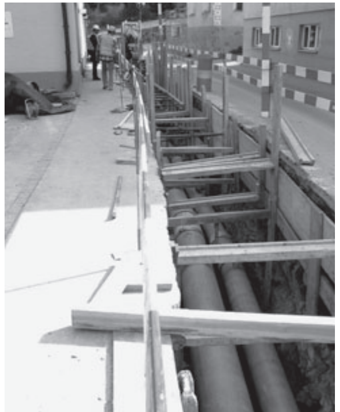
Neue Linienführung für Meteorleitung Ovel und Kanalisationsleitung für den Teil des Dorfkerns in der Via Retica.
